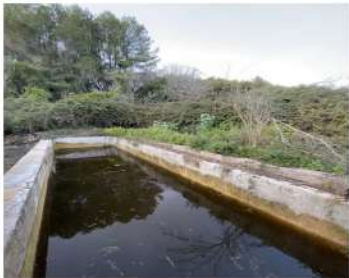
Estado Actual de estanques contaminados
